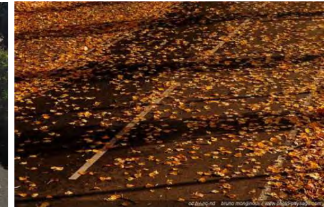
Feuilles sur aménagement — risque de chute
