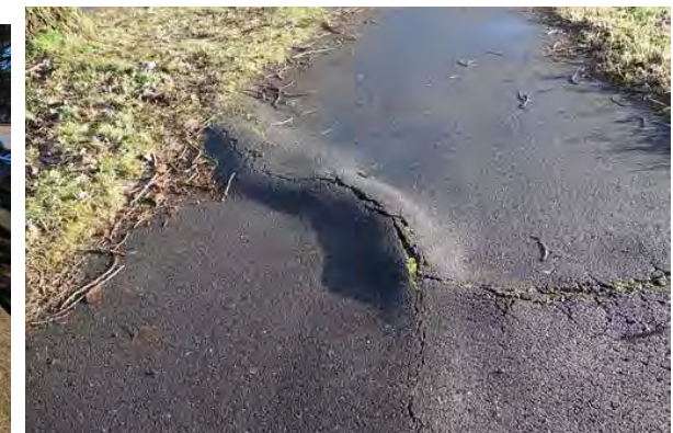
Racines d'arbres — inconfort voire chute.
